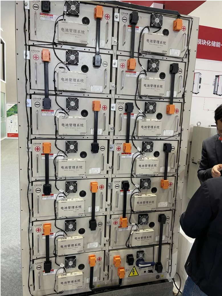
磷酸铁锂电池储能系统
